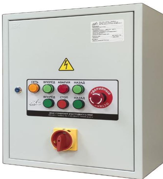
1.22 - сурет – Ілмелі-шынжырлы конвейерді басқаруға арналған щит
